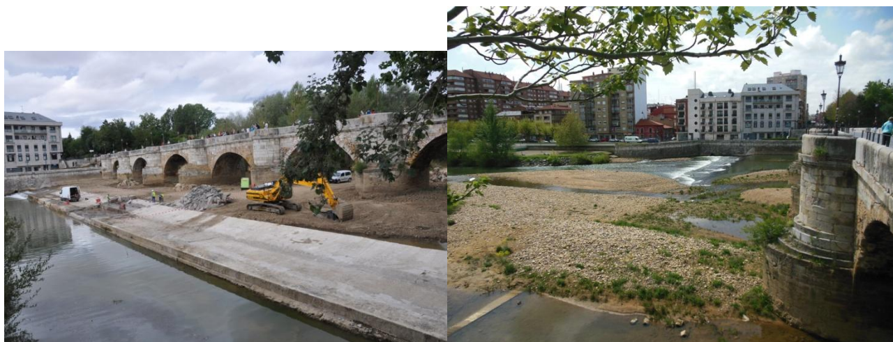
Proceso de trabajos y situación posterior (abril 2015). Fotografías de José Ignacio Santillán.
